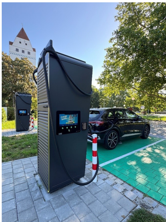
E-Ladesäulen der SWI auf dem Parkplatz „Theater Ost“
